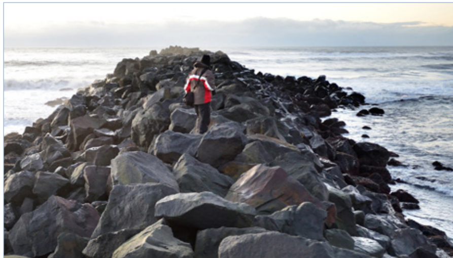
Vík í Mýrdal, sandfangari fyrir viðgerð 10. janúar 2016. Ljósmynd: Þórir N.K.
